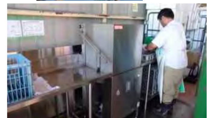
新しく設置された洗浄機。
